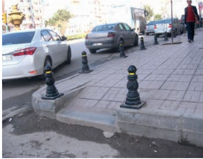
Resim 1: Uygulanması doğru olmayan kaldırım rampası Figure 1: The incorrect implementation of the sidewalk ramp
