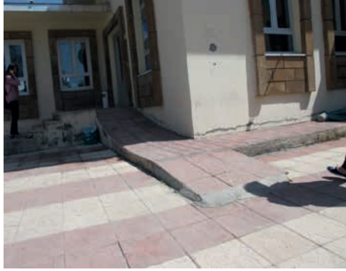
Resim3: Ulaşılabilirlik için yapılan yanlış bir rampa uygulaması Figure 3: Accessibility for the wrong application of a ramp
