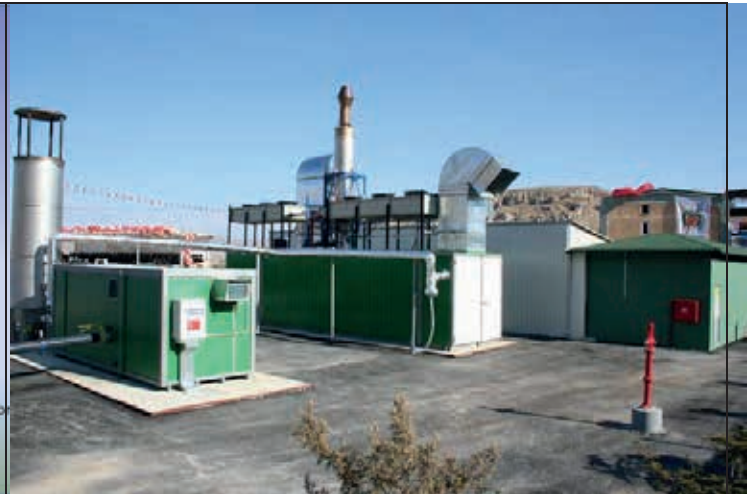
Şekil.5. Malatya katı atık kaynaklı elektrik üretim santrali
