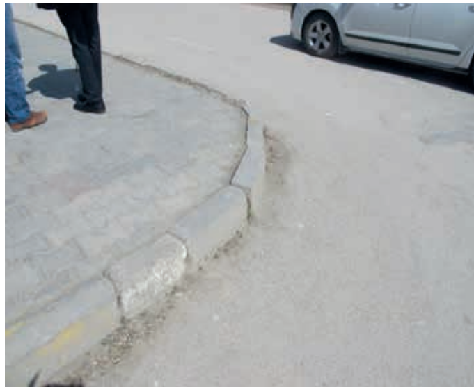
Resim 2: Rampasız kaldırımlar Figure 2: Non-ramp sidewalks
